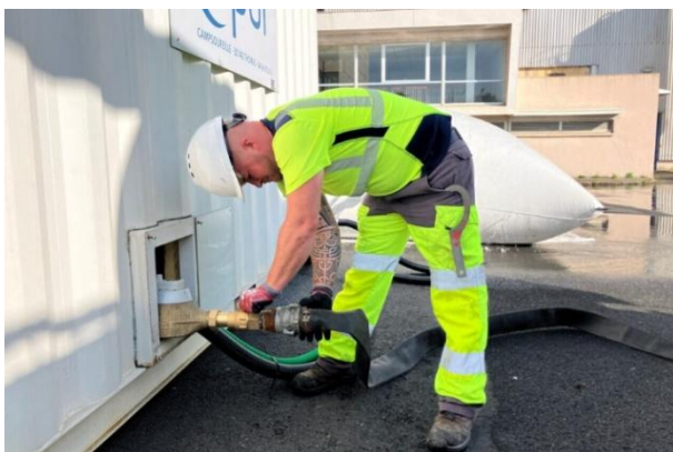
Une structure mobile sur laquelle est fixée une unité pilote qui traite l'eau en sortie de la station d'épuration de la zone portuaire (photo Eau du Ponant)
