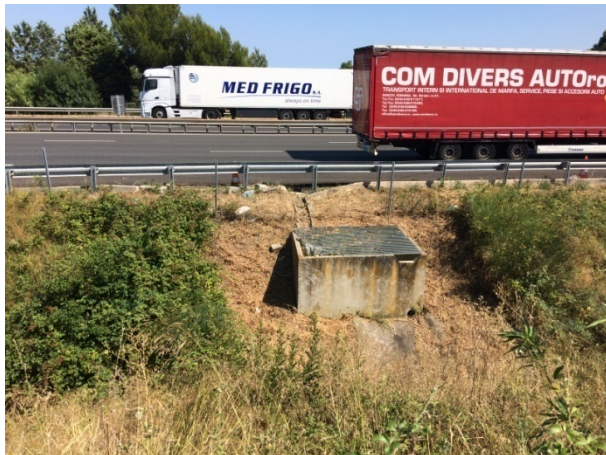
Figure 32 : Un des ouvrages de gestion des eaux de ruissellement de l'autoroute A9 à Mèze
