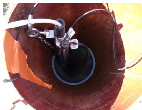
Figure 26 : Dispositif de suivi des niveaux d'eau sur un piézomètre de référence
