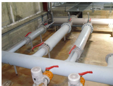
Installation de distribution d'eau dans une collectivité (chambre de vannes)
